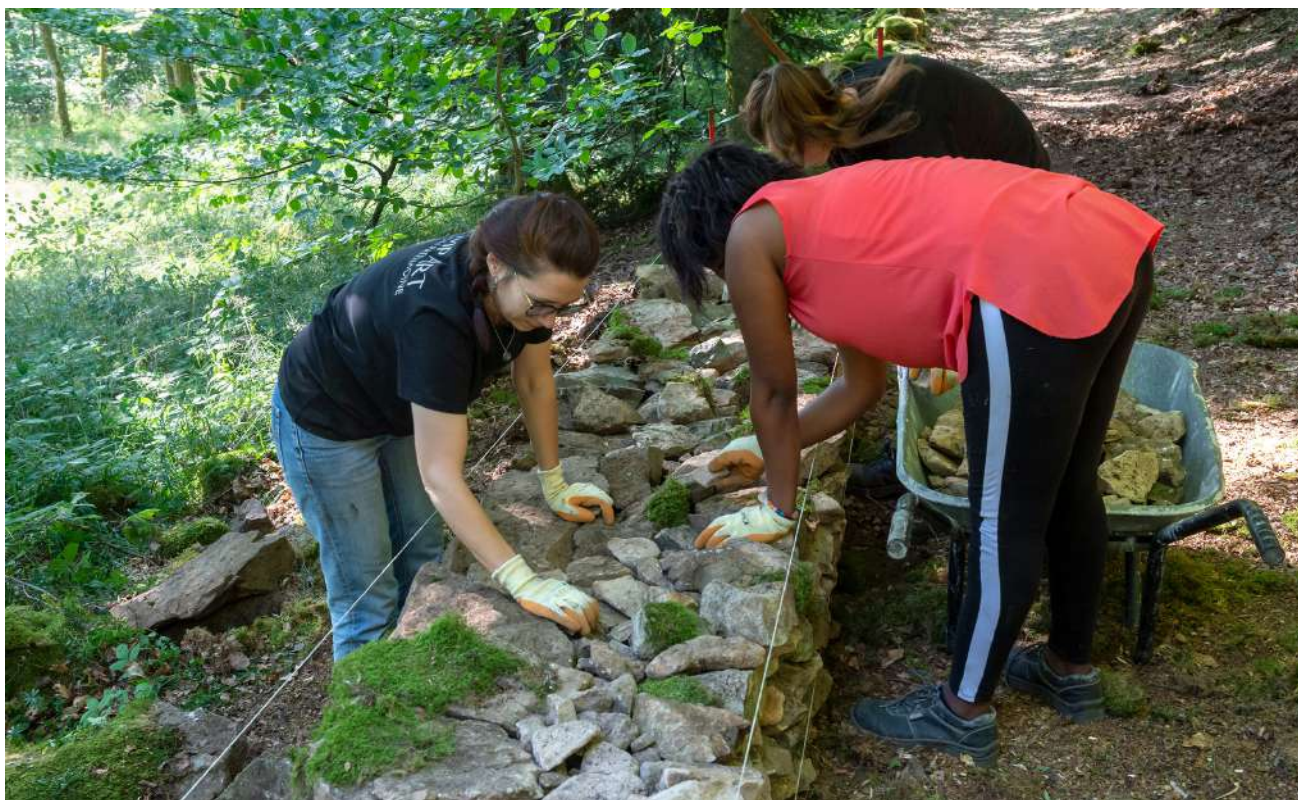
Ill. 15 : Mise en valeur et aménagement du chemin médiéval de la Place aux Laides sur le Mont-Beuvray. Chantier de volontaires « paysage et patrimoine » organisé durant l'été 2023 et encadré par des animateurs des associations REMPART et de TREMPIN, Hommes et Patrimoine. (cl. Bibracte / Antoine Maillier 2023).
